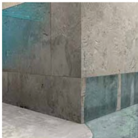
Проникновение воды через рабочий шов бетонирования
