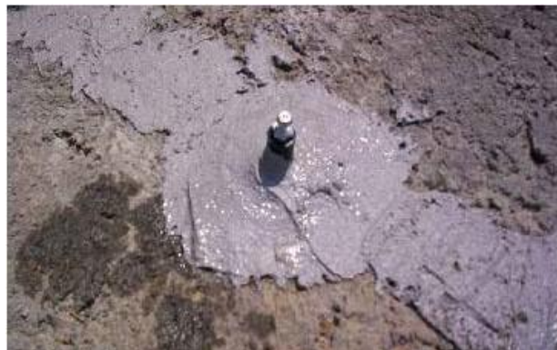
Рисунок 2. Герметизация пакера, установленного на поверхности и трещины при использовании соответствующего средства.
