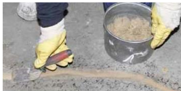
Рисунок 4. Выравнивание поверхности и трещин при помощи смеси SikalInject®-1360 RU с кварцевой мукой или песком
