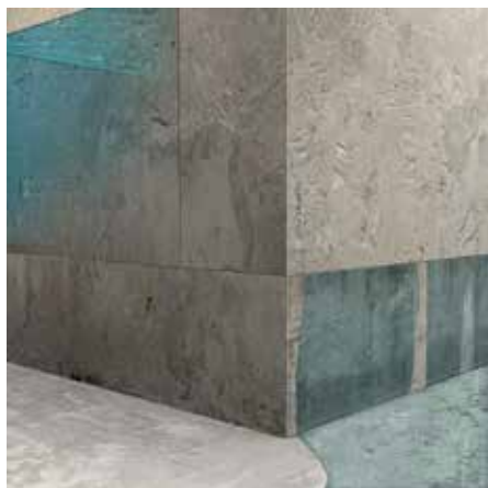
Проникновение воды через рабочий шов бетонирования
